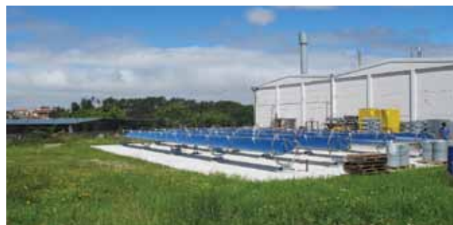
Painéis concentradores solares instalados no sistema demonstrador na SILAMPOS
